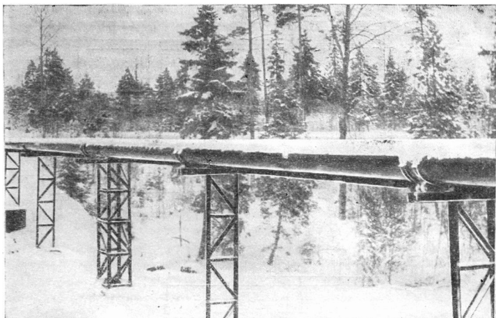
Рис. 36. Воздушный переход трубопровода.
